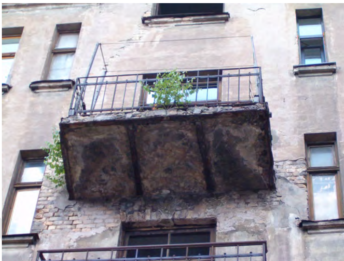
Fotoattēls Nr. 1 - ilgstošas mitruma iedarbības rezultātā bojāts balkons
