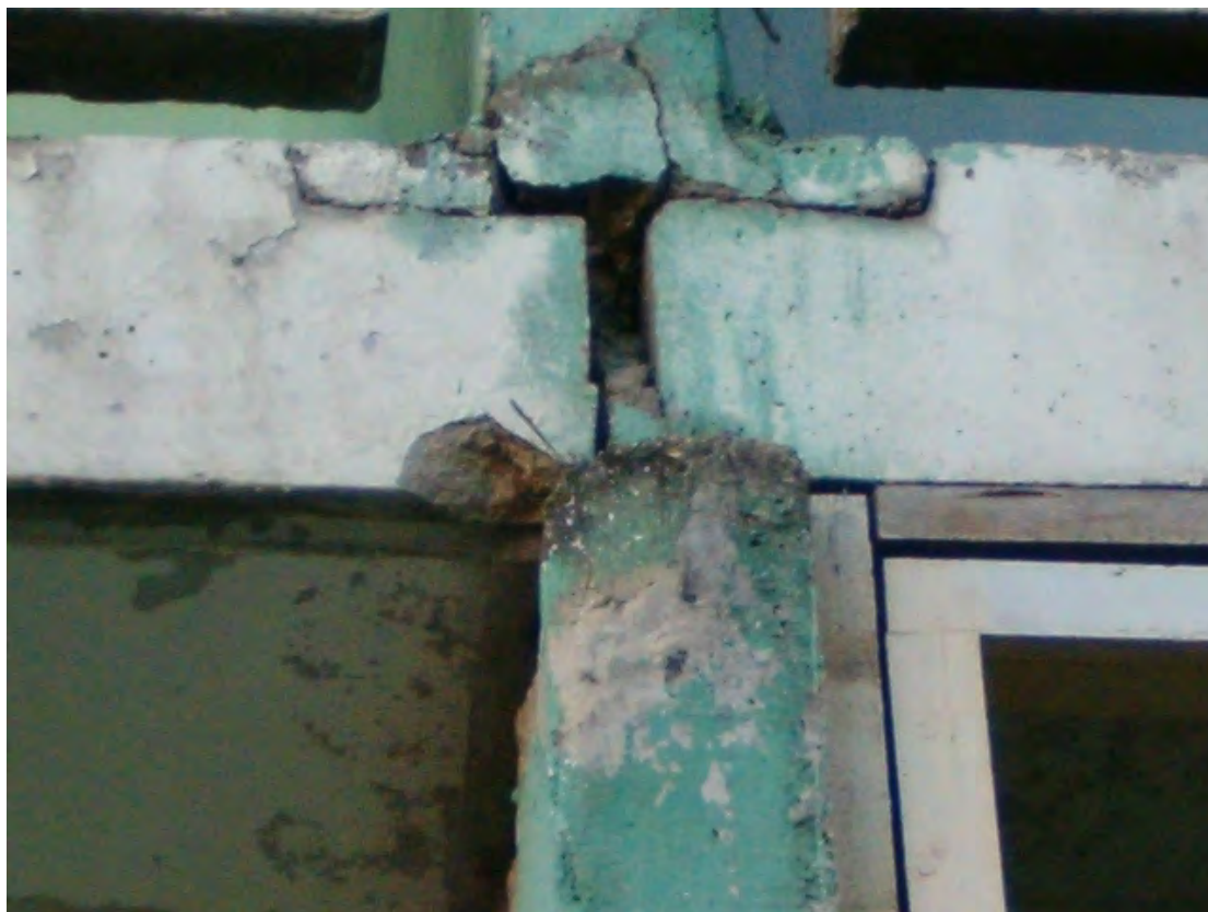
Fotoattēls Nr. 2 - nekvalitatīvi izbūvēts paneļu un pārseguma plātņu salaiduma mezgls
